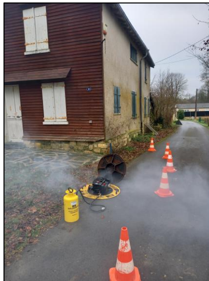
Figure 1 : Exemple de test à la fumée
