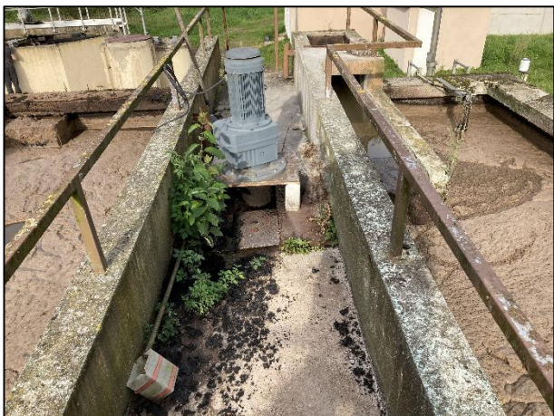
Aérateur du bassin biologique
