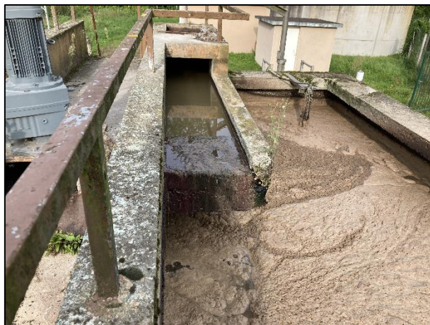
Canal de dessablage
