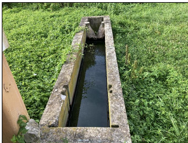
Canal de sortie
