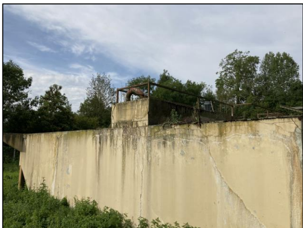
Génie civil du bassin biologique
