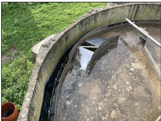
Sortie du clarificateur
