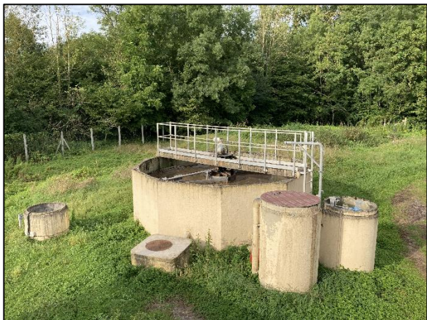
Clarificateur, dégazeur et poste de recirculation
