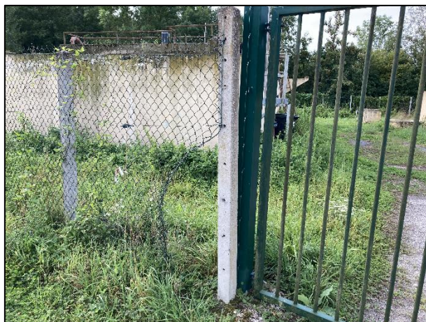
Clôture souple dégradée
