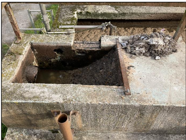
Arrivée des effluents avec dégrilleur manuel
