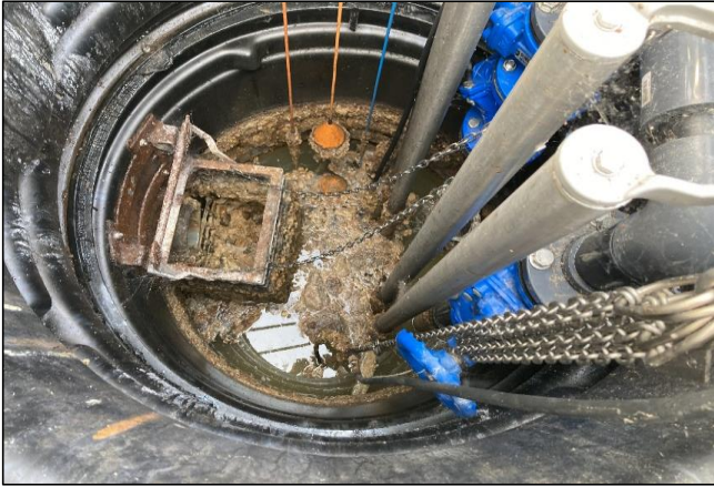
Vue sur l'intérieur du poste de refoulement
