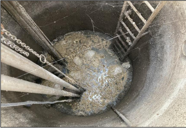
Vue sur l'intérieur du poste de refoulement
