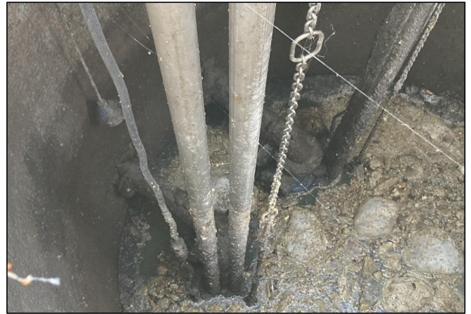
Vue sur les pompes et la poire de secours
