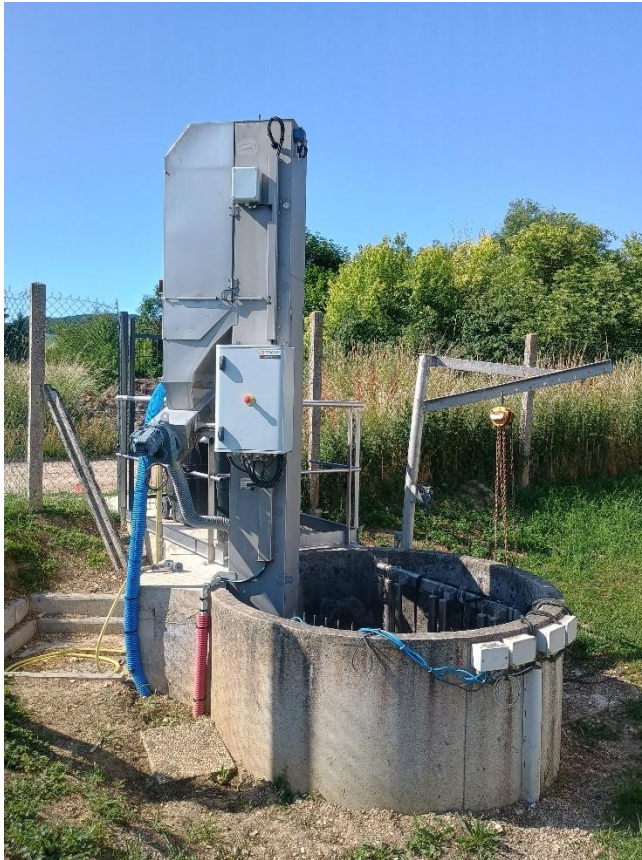
Step de Grauves – Dégrilleur automatique
