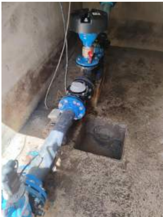
Compteur de sectorisation de Cumières
