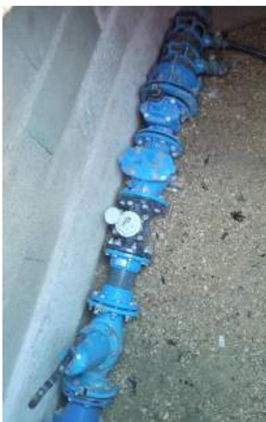
Hydraulique et compteur de sectorisation Avize Bas
